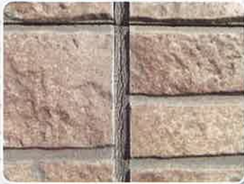
シーリングの劣化
